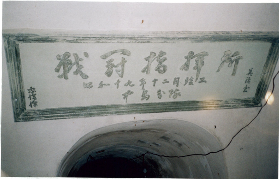
「戦闘指揮所 昭和十九年十二月竣工 中島部隊」と書かれている。
